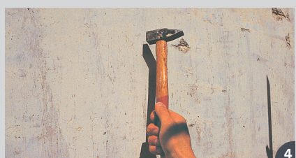
> le support doit être dur, cohésif et propre > dépoussiérer et nettoyer soigneusement le support
