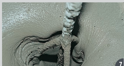
> gâcher motex fix SC 125 à l'aide d'un malaxeur électrique lent (300 tr/min), jusqu'à obtention d'un mortier homogène - consistance coulis : 4 l/sac de 25 kg - consistance mortier : 3 l/sac de 25 kg > respecter le dosage en eau
