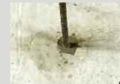
6 > les pièces métalliques ou pattes de fixation à sceller doivent être propres, dégraissées et exemptes de rouille
