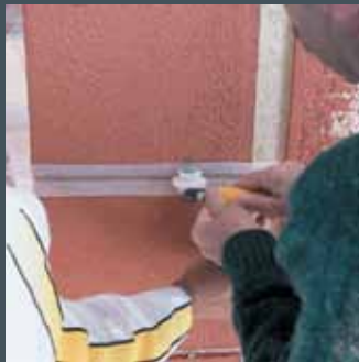
► Après découpe avec les outils listel selon calpinage, matriçage en profondeur des formes de joints
